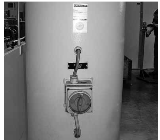
Bild 7: Anlageschalter, der in der ausgeschalteten Stellung mit einem Vorhängeschloss gegen Einschalten gesichert werden kann.
