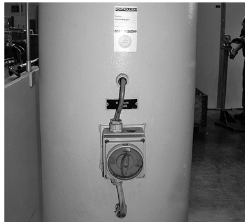
7 Anlageschalter, der in der ausgeschalteten Stellung mit einem Vorhängeschloss gegen Einschalten gesichert werden kann.
